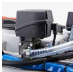
Valvola a 3 vie ad azionamento elettrico dal monitor (trattamento / risciacquo)
